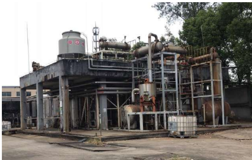
溶剂回收装置
