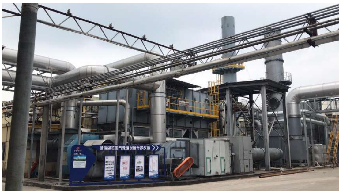
废气处理设施
